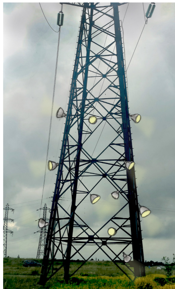
Un pylone aménagé avec des luminaires
