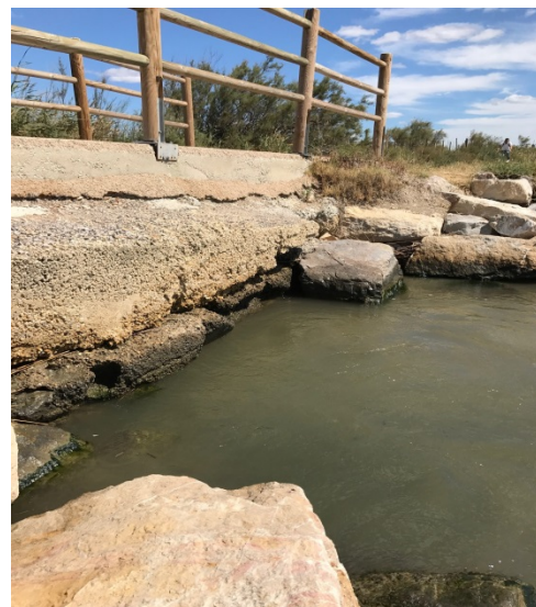
OH6 vu depuis le chenal maritime partiellement effondré
