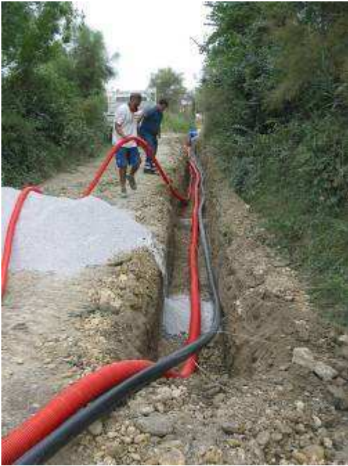
Vue du réseau de refoulement (eaux usées) et d'électricité
