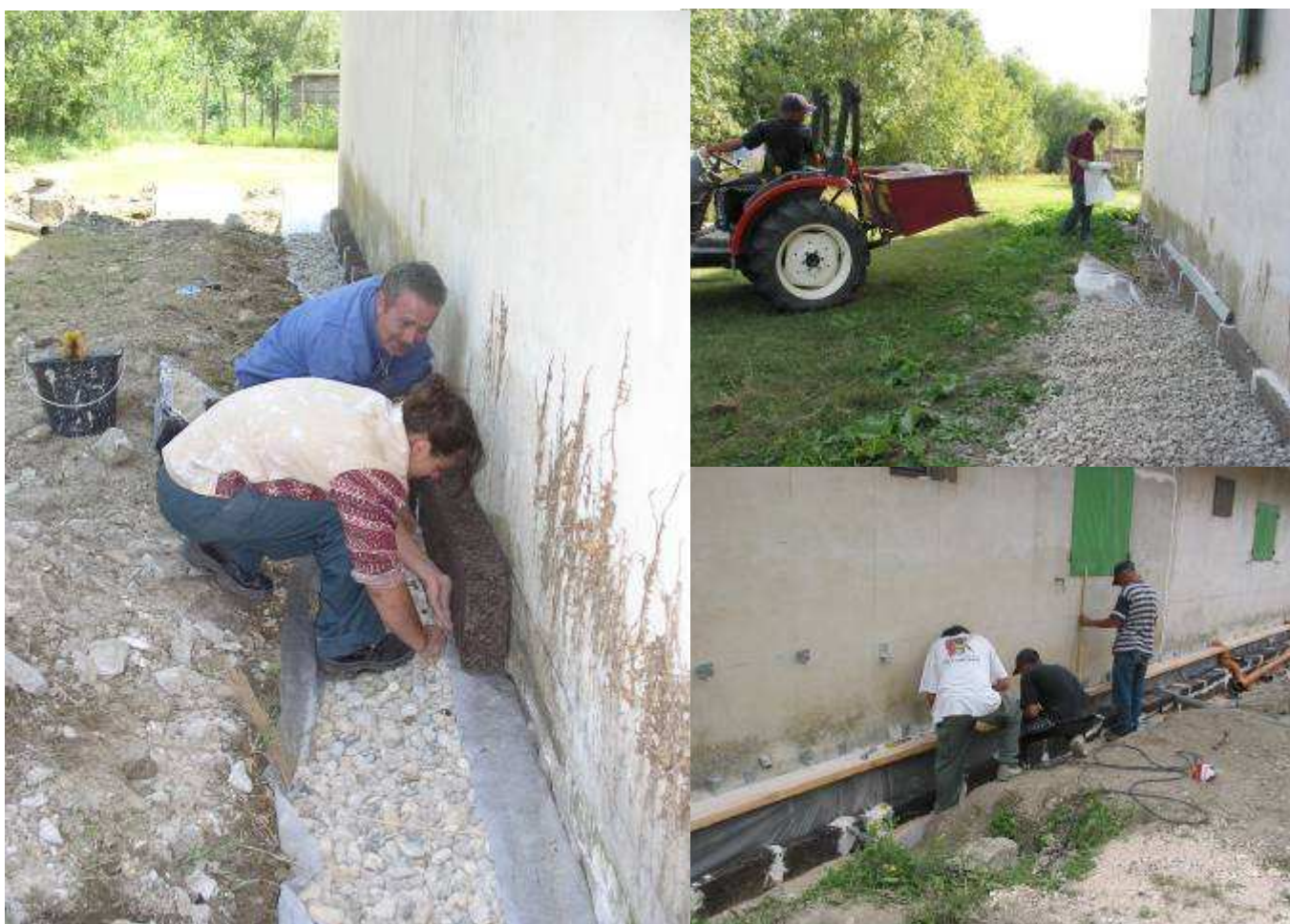
Isolation des pieds de murs en liège, protégé par du géotextile et ventilé par des galets ; pose de la lisse basse de l'isolation par l'extérieur
