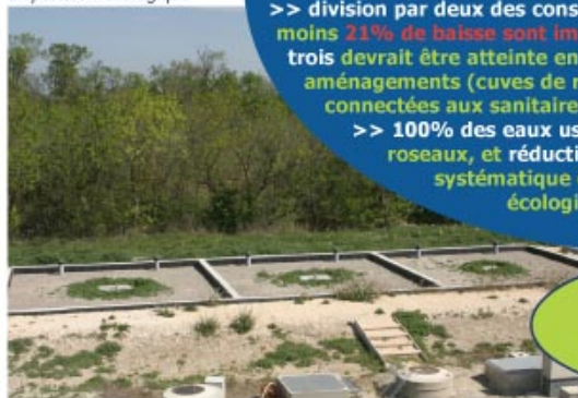
lit planté, mini station d'épuration écologique
