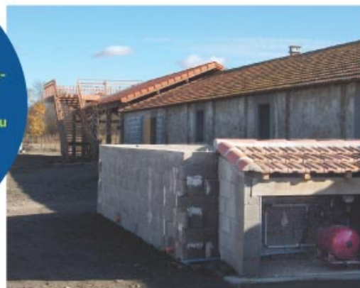
mise en réseau de cuves de récupération des eaux de pluie
