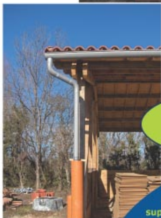
récupération des eaux de pluie
