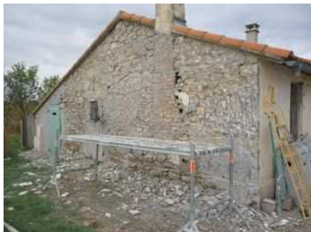
Figure 209 : apparition de désordre dans la façade ouest de la bergerie
