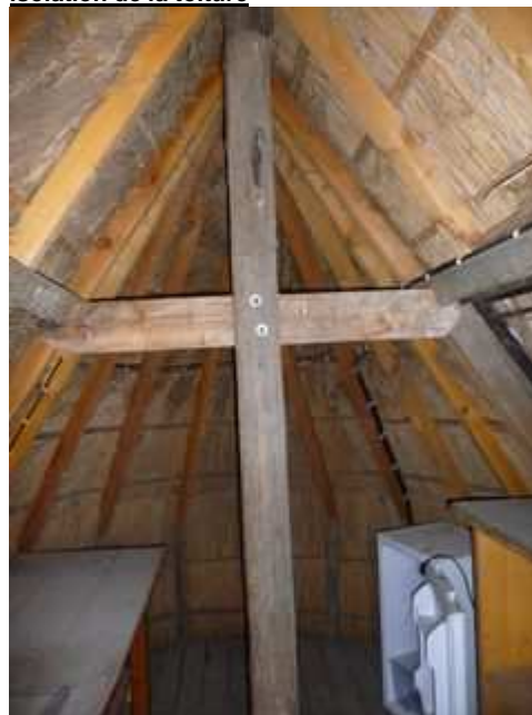
Figure 174 : présence de chaume de roseau sans isolation de la toiture
