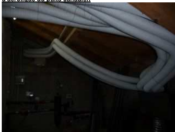
Figure 171 : vue de la circulation des équipements d'aérolitique du puits canadien
