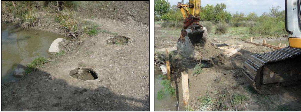
Figure 136 : Affaissements et remise en état du pont entre Fangassier et Trincanière
