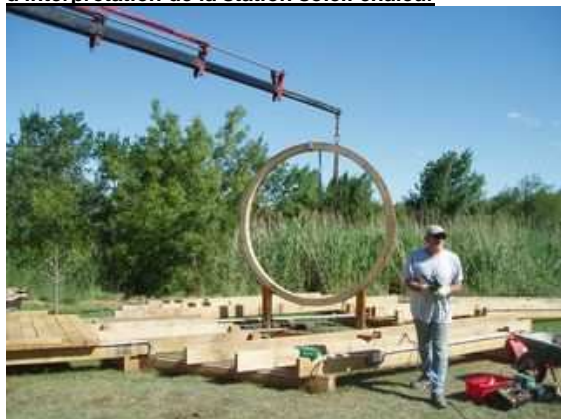
Figure 159 : pose du cadre support des installations d'interprétation de la station soleil chaleur
