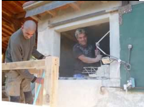
Figure 188 : agrandissement de la porte d'accès au silot et pose d'une porte métallique coulissante
