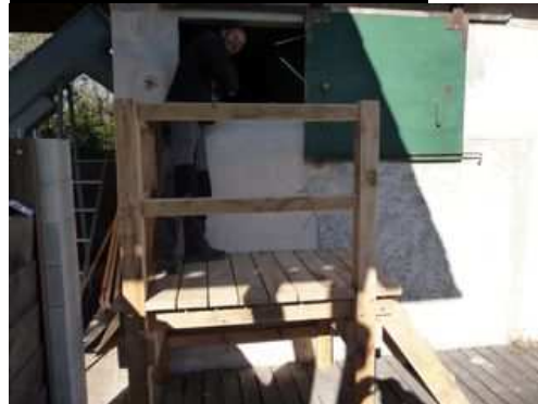
Figure 189 : plateforme avec rambarde et escalier pour le remplissage du silo de la chaudière
