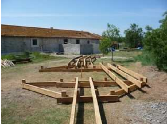
Figure 152 : Pose des fondations du platelage de la station d'eau pluviale et plaquage en fausses pierres de la cuve
