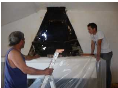
Figure 205 : déconstruction de la cheminée de la bergerie suite à un désordre dans le mur
