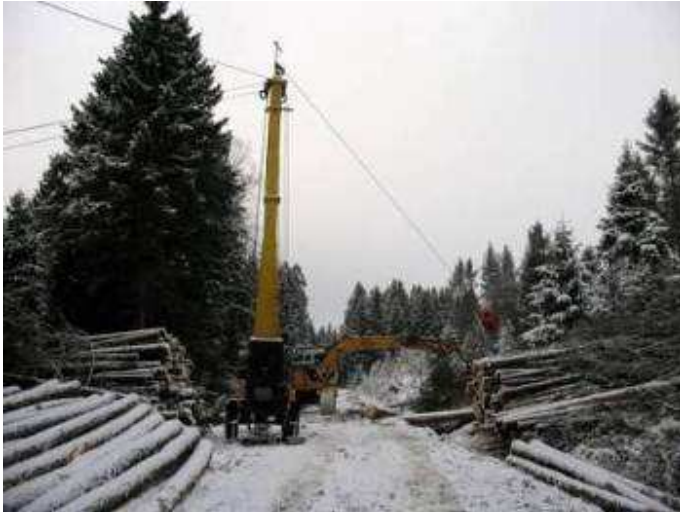
Photo 11 : le dispositif se compose d'un mât métallique haubané, d'un câble et d'un chariot motorisé. (crédit PRT)
