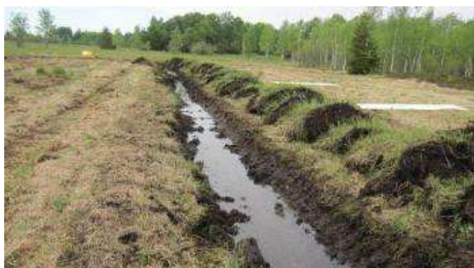
Photo 5 : le curage du fossé est nécessaire pour assurer une bonne cohésion de la sciure et de la tourbe. La tourbe curée est stockée à proximité immédiate du fossé en vue de son utilisation ultérieure. (crédit CFD)
