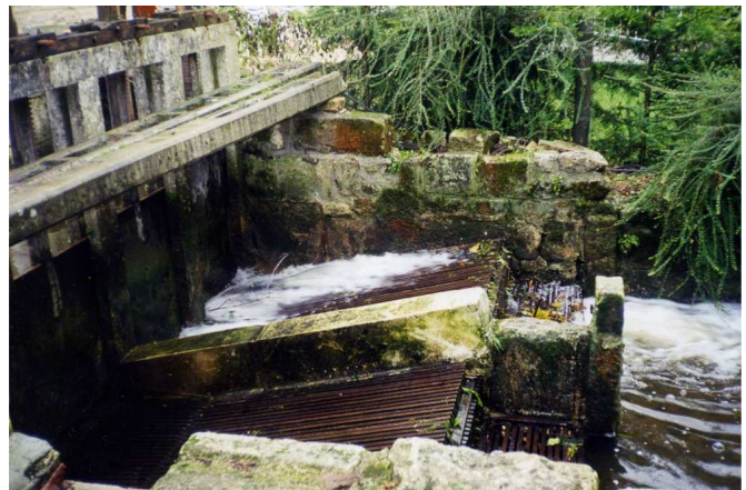
Installation d'une "anguillère" sur la Boutonne (Charente-Maritime – photo E.SABOT 1999)
