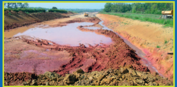
Positionnement inadéquat de l'ouvrage
