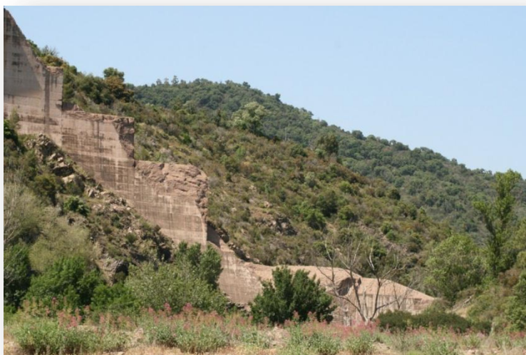
Ruines du barrage de Malpasset
