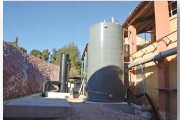
Nouvelles installations à la STEP d'Agay @CAFSR
