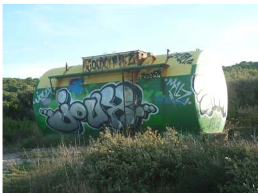
Ancienne citerne HBE dégradée
