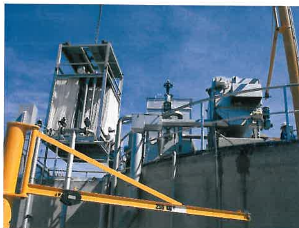
Membrane de filtration à Fitou
